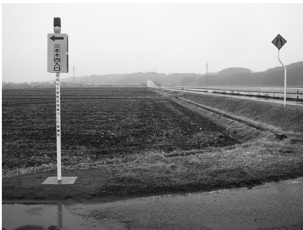
危険箇所への回転灯の設置
