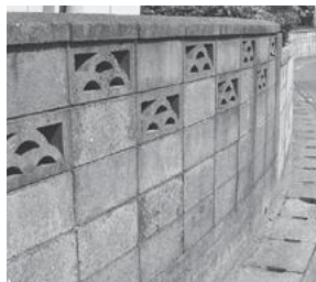
通学路のブロック塀
