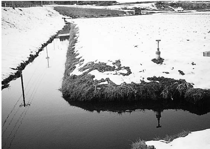
大雨により土砂に埋ったコンクリート製の用水路
