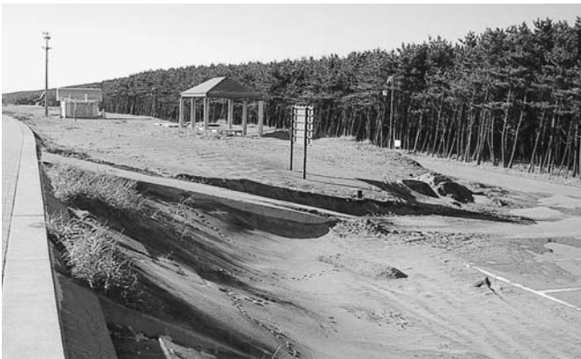
吹き上げられた砂が堆積し心配される！ (二川目海浜公園)
