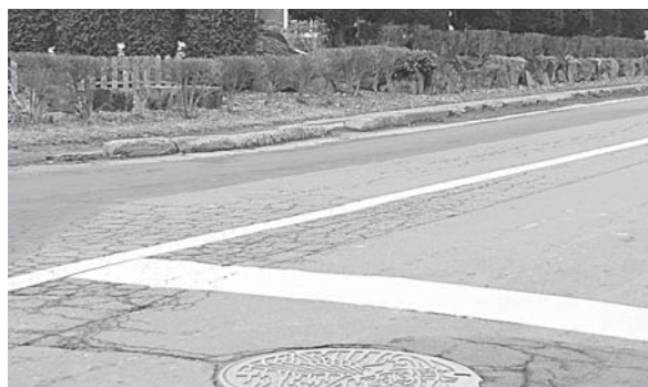
路面・縁石が損傷している木ノ下・三沢線
