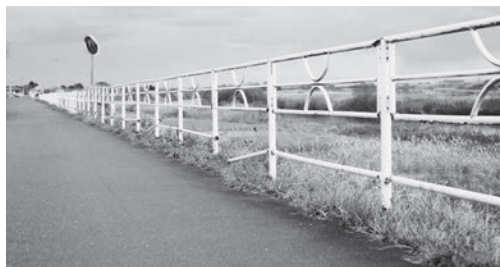
▲破損している安全柵
