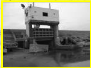
一の川防潮水門損壊
