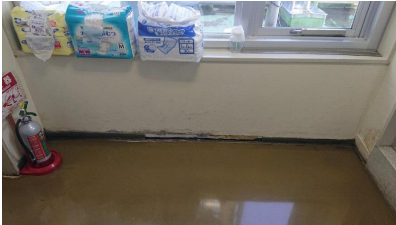
(病棟階の壁面漏水箇所)
