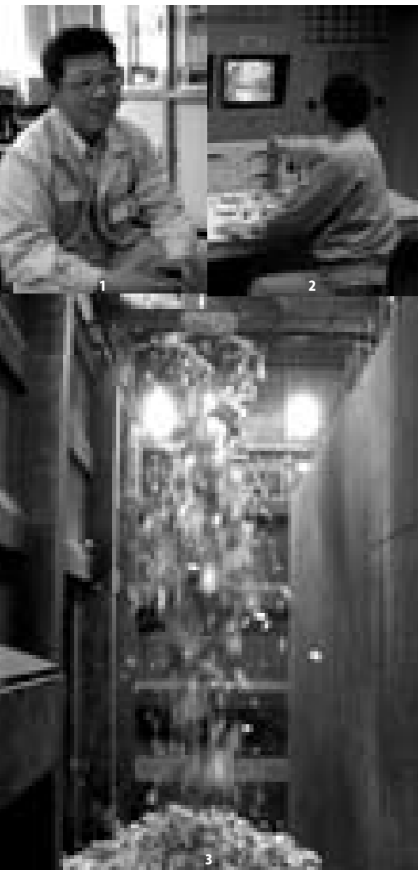
1_インタビューに応じた佐々木課長補佐 2_中央制御室のようす。4つのモニターがさまざまな作業経過を映し出す 3_ごみ貯留ピットの中で可燃ごみをクレーンでかき混ぜる。ごみの質を平均化させ、炉の温度を保つことでごみを効率よく燃焼する
