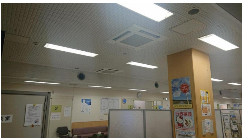
(待合ホールエアコン)
