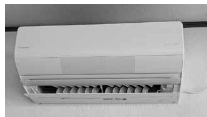
▲設置されたエアコン
