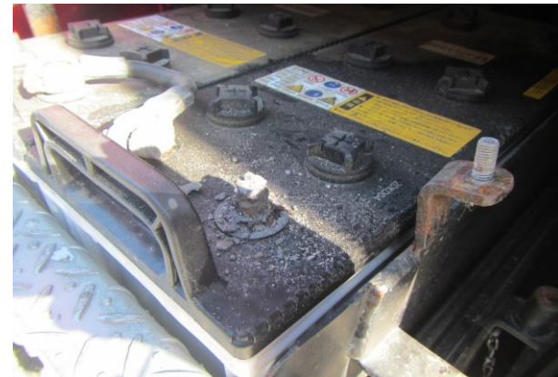
バッテリープラス端子劣化(摩耗)
