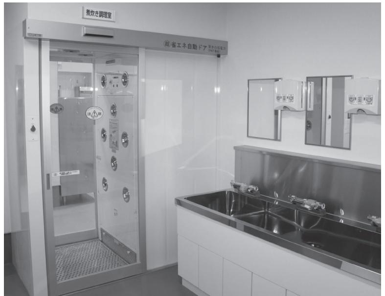
衛生管理のためエアシャワーが設置された給食センター内部
